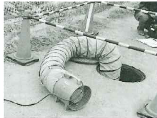
【調査時の安全対策(千代川線)】 調査時は管内の換気を実施
