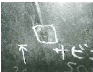
【鋼管の状況(八郷幹線)】 溶接部に軽微な錆腐
