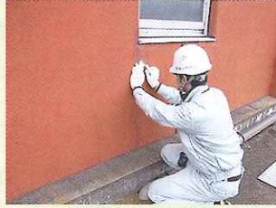
外壁クラック幅測定
