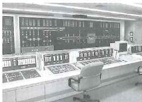
監視制御設備（旧）
