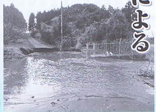
水機構基幹線土浦3号排泥工
